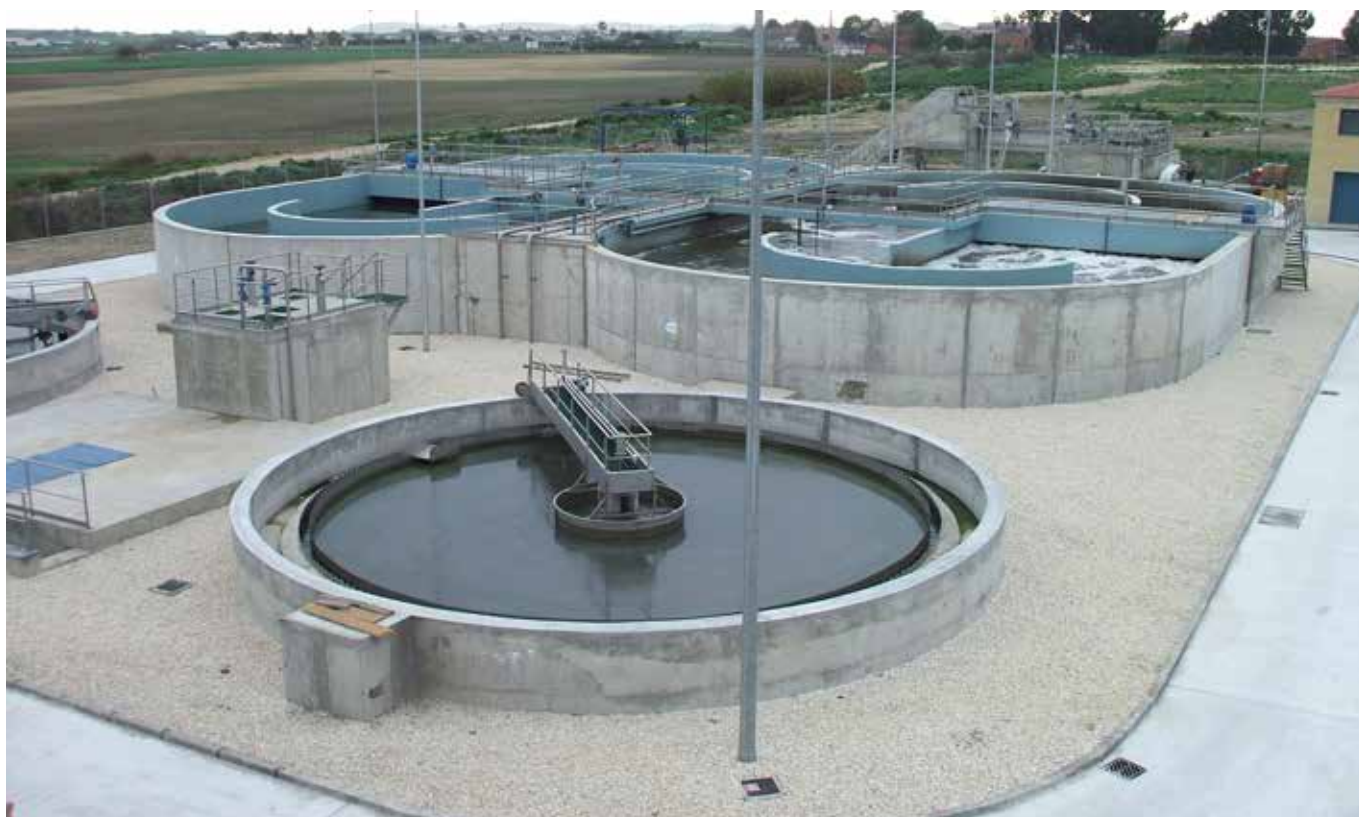
CP Asturias - Estación EDAR
